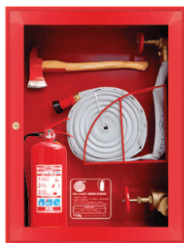
GABINETE CONTRA INCENDIOS
